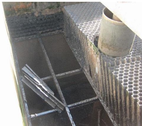
Packungen ersetzen beim Lamellenklärer
