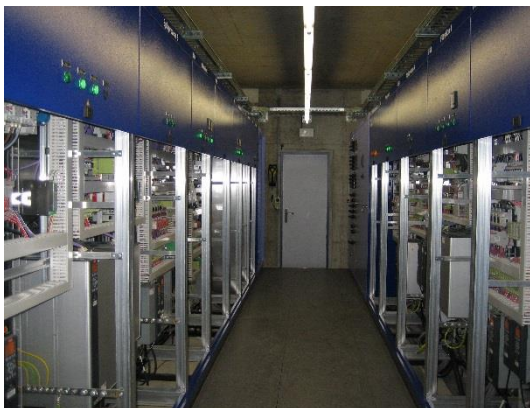
Umgebaute Schaltanlage bei der Biologie
