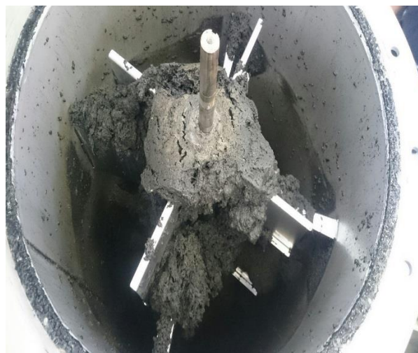
Verzopfungen am Mischbehälter
