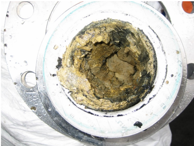
Fettablagerung in Ansaugleitung zur Pumpe
