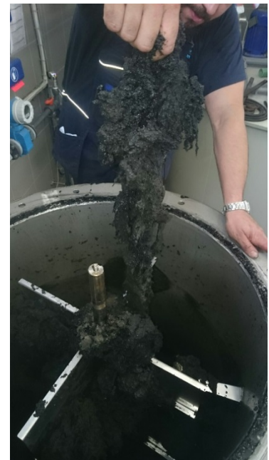
Verzopfungen am Mischbehälter
